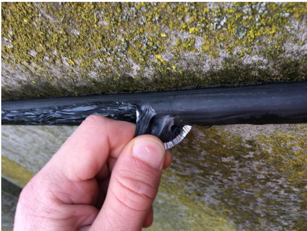
Foto 7: Eksempel på reparation med ukendt tapeprodukt, som vurderes ikke at yde tilstrækkelig vandtætning. Holdbarheden er i øvrigt ukendt.
