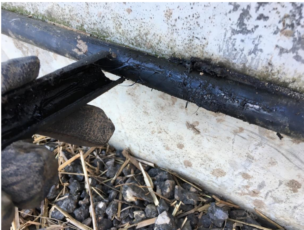
Foto 15. Samme reparation som på forrige foto. Der er smurt med et ukendt produkt mellem kabel og plastkappe, men plastkappen kan let tages af og reparationen er ikke vandtæt.
