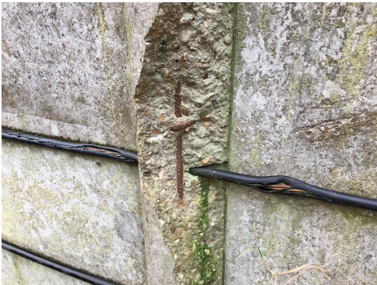
Foto 2. Større skader på kabelbeskyttelsen efter påkørsel.
