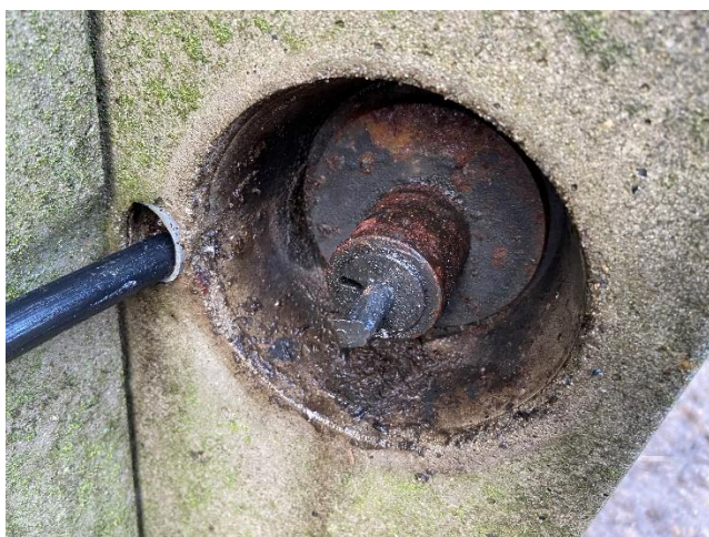
Foto 3. Korrosion på ståldele.
