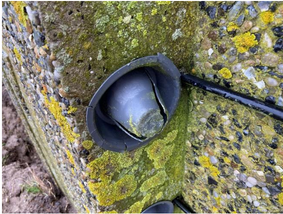
Foto 32. Beskadiget afdækningshætte på Muleby beholder.
