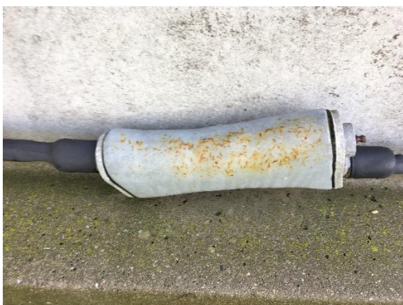
Foto 21. Mindre grad af overfladerust på låsens overfladebehandling.
