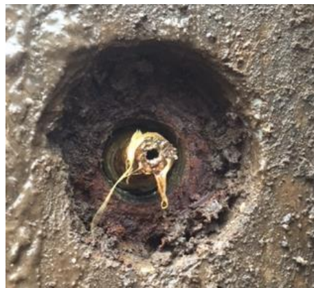
Foto 2. Tegn på defekt kabel (hertekordellen er sunket ind).
