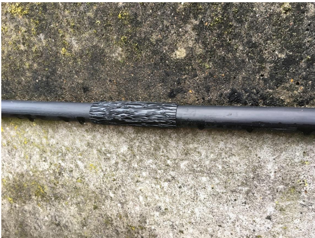
Foto 6: Eksempel på reparation med ukendt tapeprodukt. Se også følgende foto.
