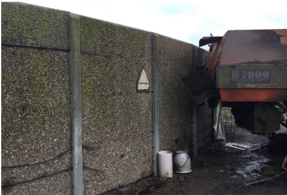
Foto 1. Omfattende skader på kabler efter brand.
