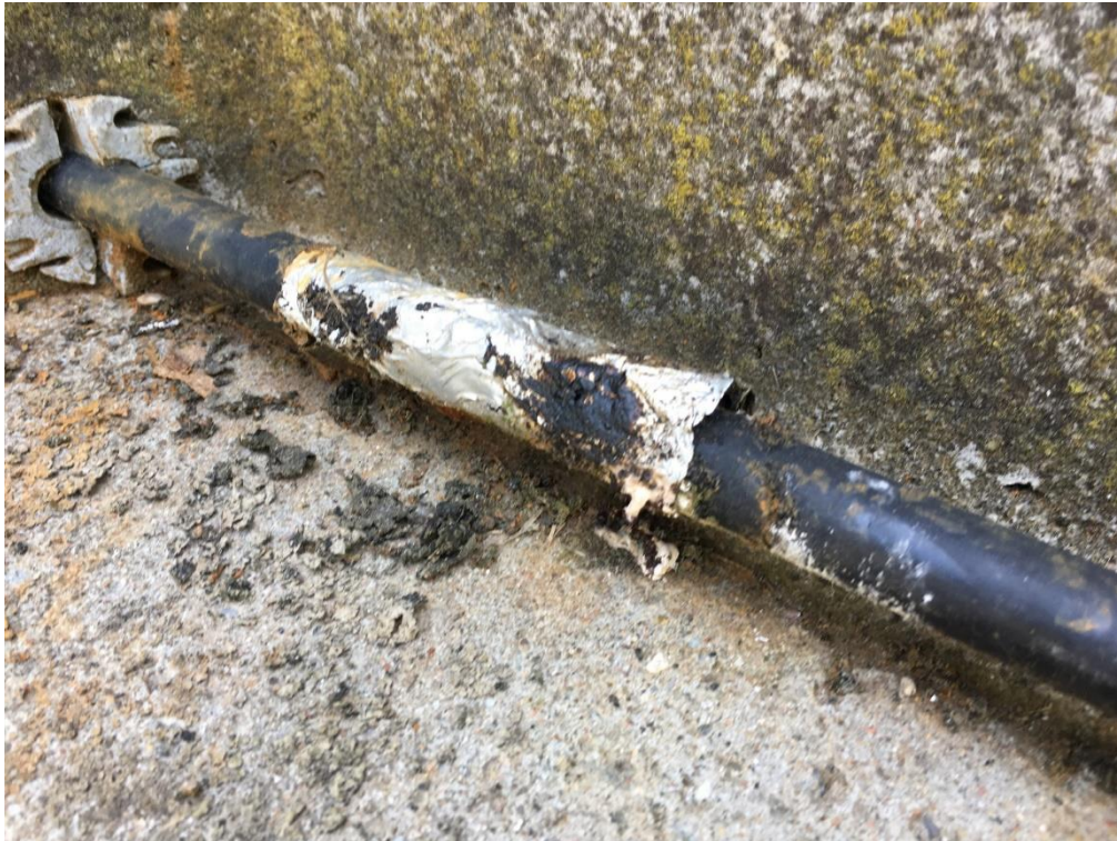
Foto 10: Eksempel på ældre reparation med bitumenbaseret tape som bør undersøges nærmere/skiftes.
