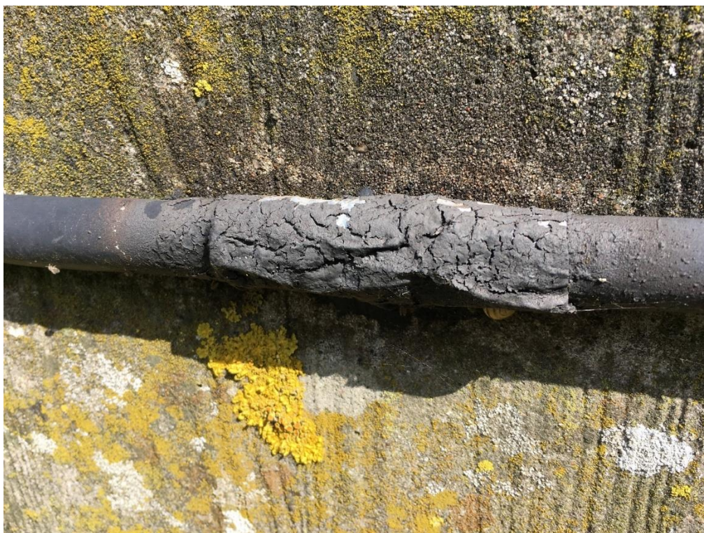
Foto 13: Eksempel på reparation med formentlig bitumenbaseret tape, som efterfølgende er sprøjtet over med et tectyl lignende produkt. Denne reparation bør undersøges nærmere/skiftes.
