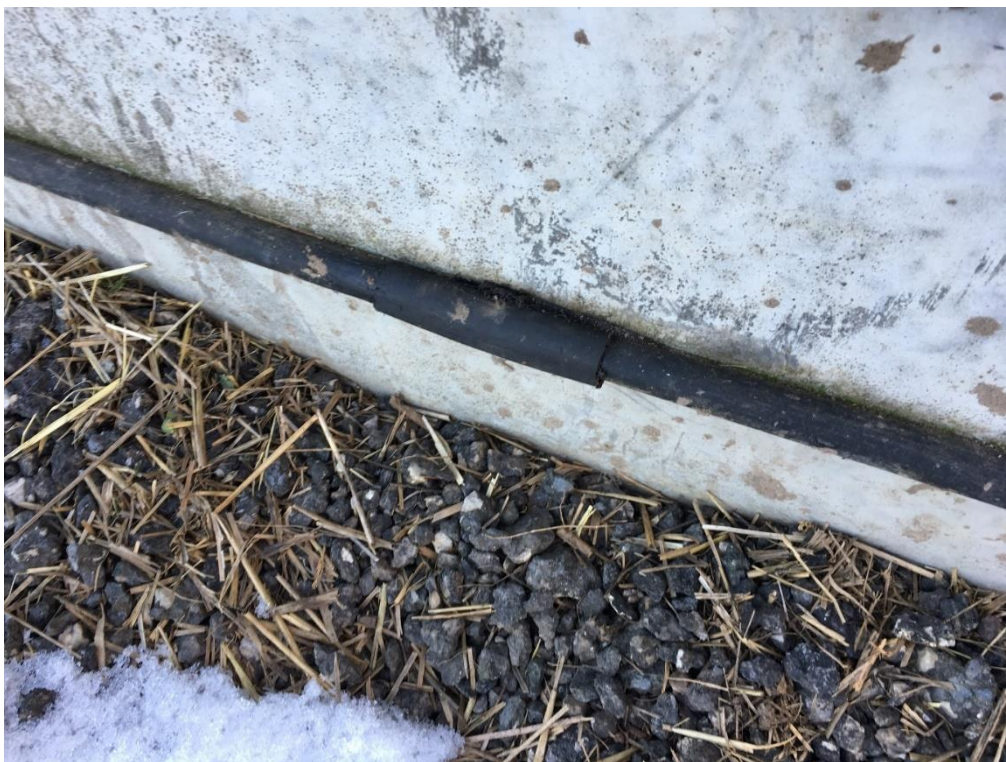
Foto 14. Eksempel på reparation med udskåret plastkappe, hvor der er sat en plastkappe udover. En sådan reparation vil ikke være vandtæt.
